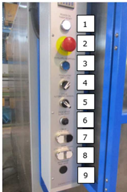
Foto 10 – Pulsantiera di comando
